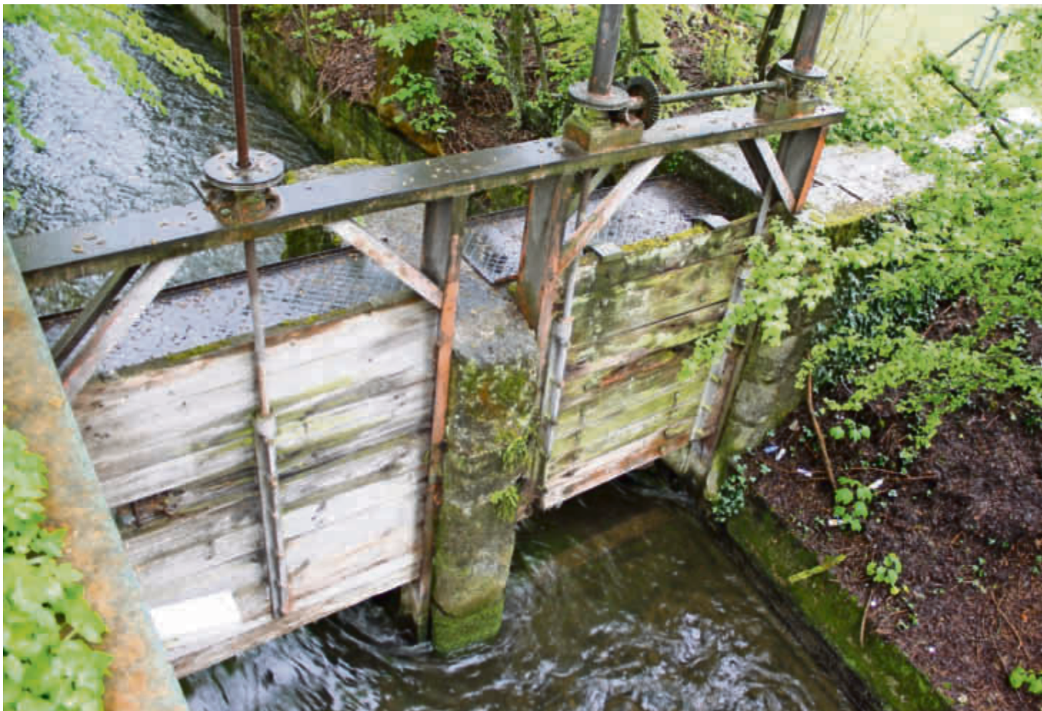
Mit dem alten Wehr bei Stegen in Robenhausen liess sich 1857 erstmals die Wassermenge im Aabach regulieren.
