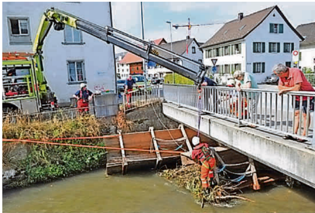
Während des Unwetters am 7. August 2013 schwemmte es in Uster einen Notkanal der Wehr-Baustelle auf Höhe der Zellweger-Schleuse den Aabach hinunter. Die Feuerwehr musste den Kanal bergen. np
